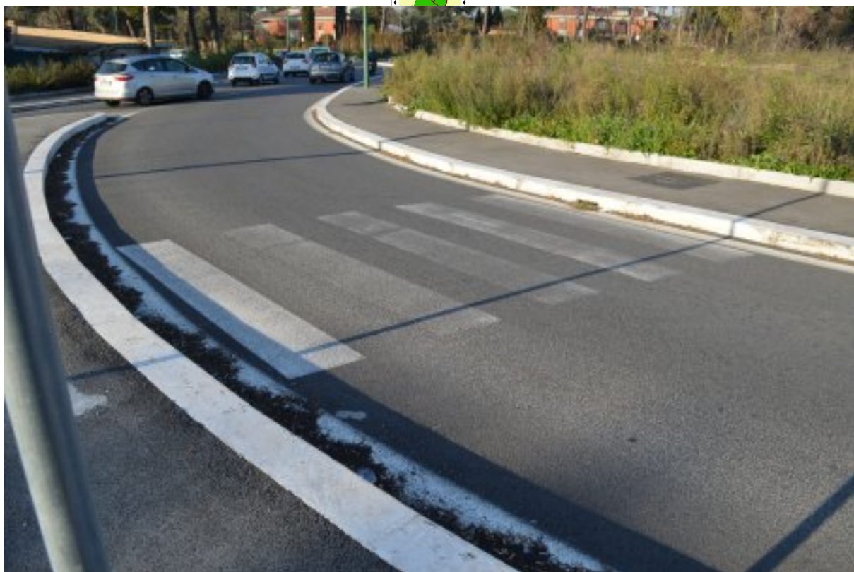
Foto 6 – immissione della via di Tor Carbone sulla rotatoria, strisce realizzate il 29 maggio 2016, notare la totale assenza di passaggi per diversamente abili
